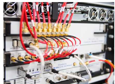
รูปที่ 5 ส่วนการเชื่อมต่อสัญญาณและระบบอินเทอร์ล็อก ในตู้ระบบควบคุมคลื่นวิทยุกำลังต่ำ
